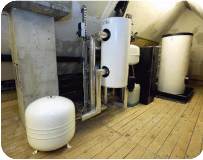
Unter dem Dach befinden sich die Ausdehnungsgefäße, der PVT-Speicher, die Wärmepumpe, die schwarze thermische Batterie sowie der Trinkwarmwasserspeicher. FOTOS (2): ENERGIEKONSENS/M. ROSPEK
