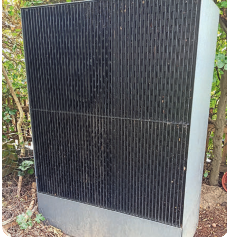
Die Außeneinheit der Wärmepumpe hat das Paar im hinteren Teil des Gartens aufstellen lassen. FOTOS (2): SEEBACHER
