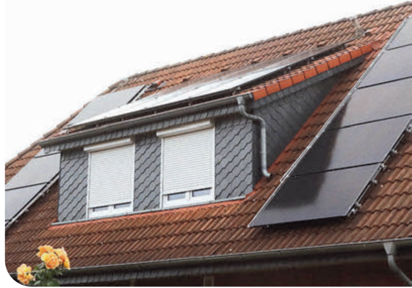
Noch gehört PVT nicht zu den Standardlösungen im Gebäudebestand. Fachleute beobachten jedoch, dass die Technik zunehmend in Serie gefertigt – und dadurch wirtschaftlicher wird.
