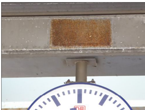
Abbildung 18: Die in die Dachträger integrierten Lautsprecheröffnungen in Bremerhaven-Lehe wiesen Korrosion auf.
