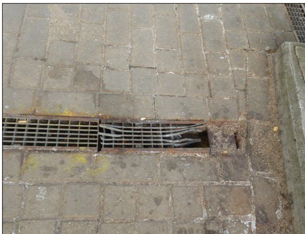
Abbildung 8: Die Entwässerungsrinne am südlichen Ende des Bahnsteigs in Bremen-Walle war beschädigt.
