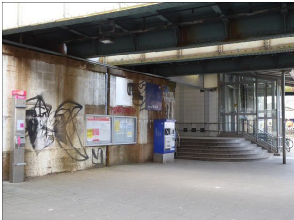
Abbildung 40: Der Zugang zum Bahnsteig in Bremen-Walle wird durch Schmierereien, Verschmutzungen und Ausblühungen im Mauerwerk beeinträchtigt.
