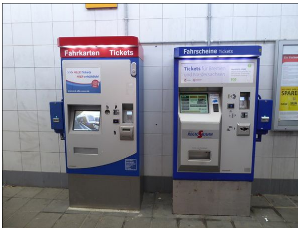
Abbildung 32: Im Tunnel von Bremerhaven-Lehe standen wieder beide Fahrkartenautomaten zur Verfügung. Trotz grüner Kontrollleuchten funktionierten jedoch beide Entwerter nicht.
