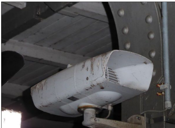
Abbildung 47: Lautsprecher unter dem Bahnsteigdach in Bremen-Vegesack waren mit Taubenkot verschmutzt.
