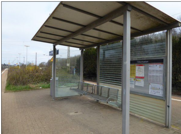
Abbildung 43: Zusätzlich zu der bereits vor einem Jahr fehlenden Seitenscheibe fehlte im Unterstand in Bremerhaven-Wulsdorf auch eine Scheibe in der Rückwand.
