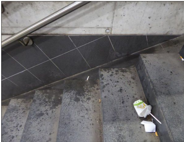
Abbildung 35: Sowohl die Treppe als auch die Rampe und der Tunnel in Bremen-Oslebshausen waren vermüllt und stellenweise verschmutzt.
