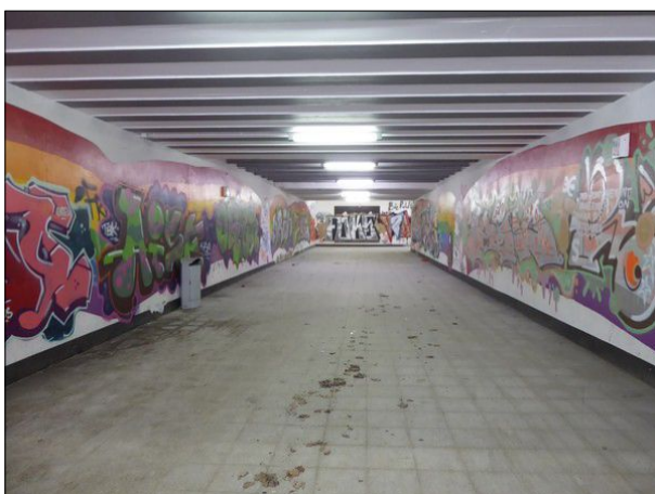
Abbildung 45: Der Tunnel zum Bahnsteig in Bremen-Neustadt ist umfangreich beschmiert. Zudem gibt es Schäden an der Decke und weitere Verschmutzungen.
