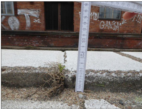
Abbildung 7: Am Bahnsteig in Bremen-Sebaldsbrück waren die Pflastersteine vor den Bahnsteigkanten stellenweise mehr als 4 cm abgesackt.
