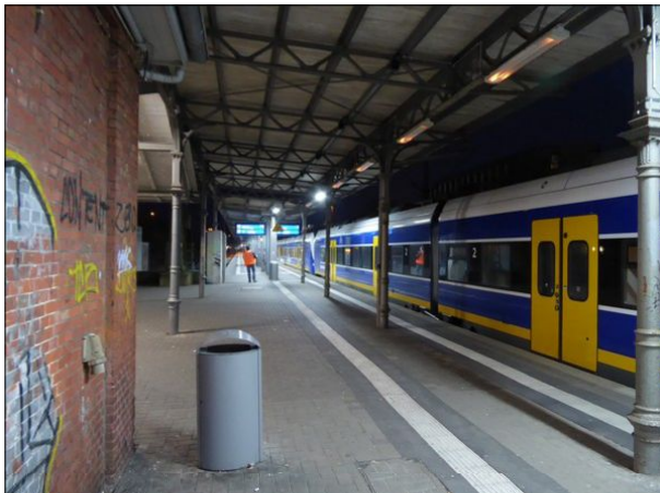
Abbildung 37: In Bremen-Vegesack waren an Gleis 1 bis zu vier Dachleuchten nebeneinander defekt.
