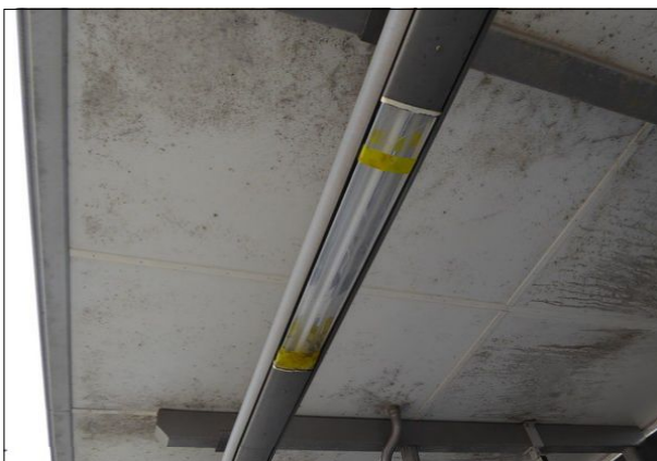
Abbildung 12: Die Dachunterseite an Gleis 2 in Bremen-Burg war verschmutzt. Zudem waren einzelne Leuchten provisorisch mit Klebeband oder Kabelbindern befestigt.
