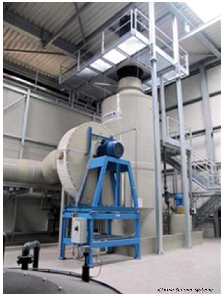
Abb. 2: Beispiel des Gaswäschers
