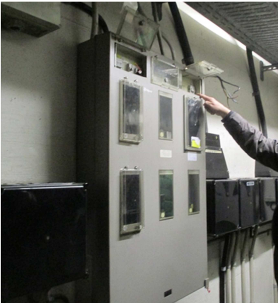
Abb. 2: Schaltraum mit Verteilung
