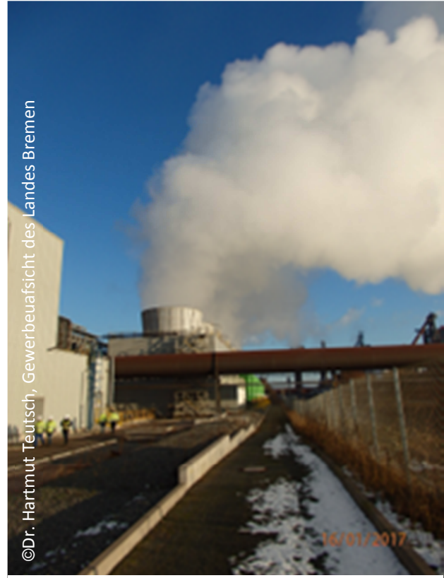
Abb. 2a: Großes Rückkühlwerk als Verdunstungskühler
