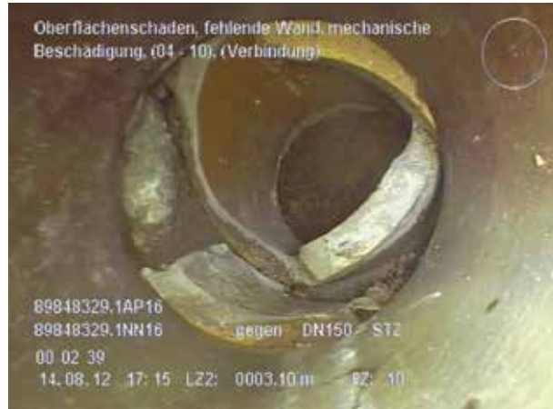
Defekte Leitung – Fehlende Wand
