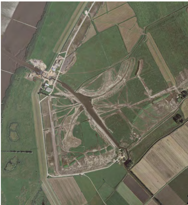
Abbildung 135: Bau eines sperrwerksgesteuerten Tidepolders mit Prielen auf der Luneplate südlich von Bremerhaven (Bauzustand 2008)
