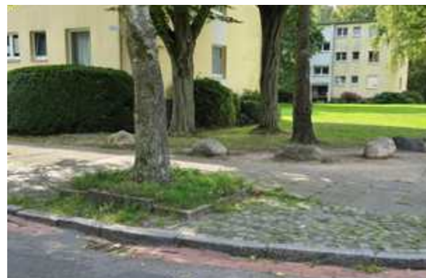
Abb. 22 und 23: Schadensbilder: 1. Falscher Standort: Baum zwischen zwei Zufahrten. Vergrößerung der Baumscheibe nicht möglich. Georg-Gröning-Straße. 2. Zu kleine Baumscheibe mit Hochbord eingefasst in der Adolf-Reichwein-Straße. Vergrößerung auf 9,5 m x 1,5 m möglich. Fotos: SUKW / Iris Bryson.
