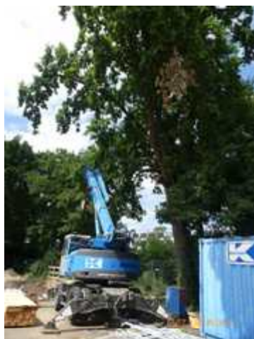
Links: Gestellter Kran in Bereich der reduzierten Krone von Baum Nr. 30 (Abb. 8).
