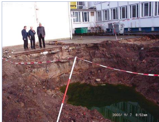
Abbildung 8: Ölschaden nach Ausbau eines Tanks auf einem Grundstück an der Industriestraße
