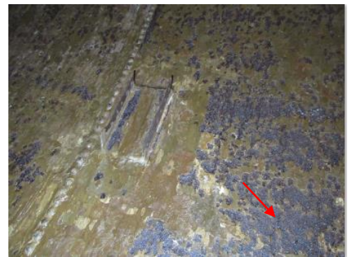
Zementbeschichtung (oliv) mit Fehlstellen (grau).
