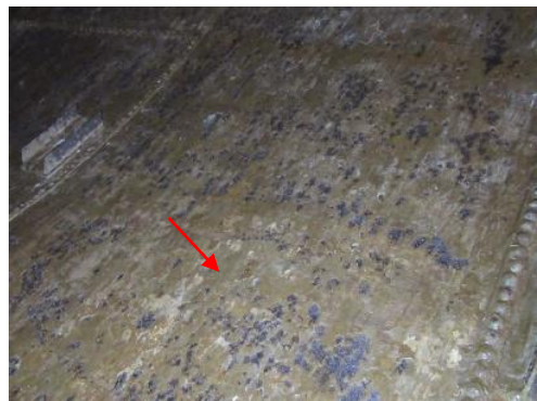
Zementbeschichtung (oliv) mit Fehlstellen (grau).
