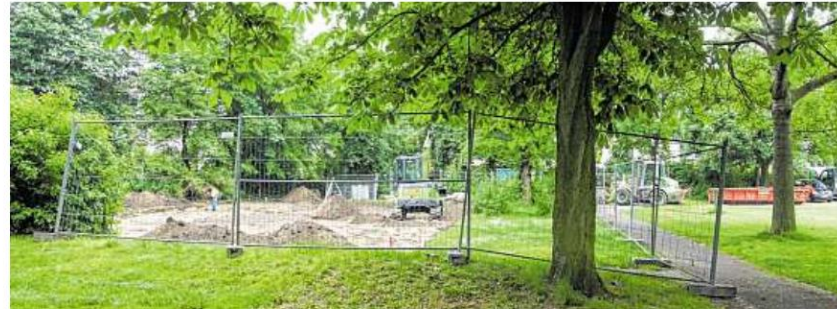
Seit Mittwoch laufen die Bauarbeiten für einen neuen Ballspielplatz zwischen Stoteler Straße und dem Grünzug West im Ortsteil Ohlenhof. FOTO: FR
