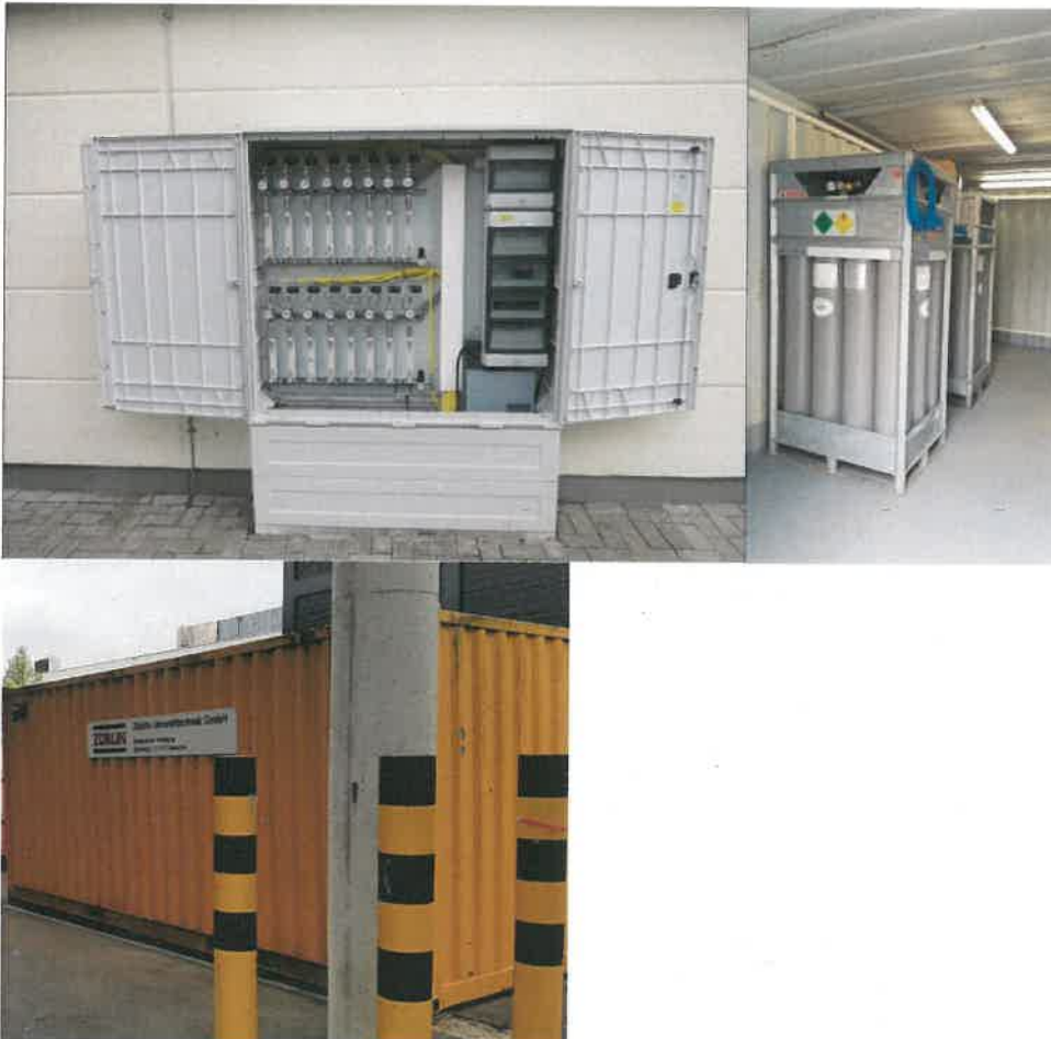
Abb. 5: Gasinjektionsanlage (ähnlich der Konzeption - Feldversuch) mit elektrisch gesteuerten Pegeln und Gasstation der Züblin Umwelttechnik
