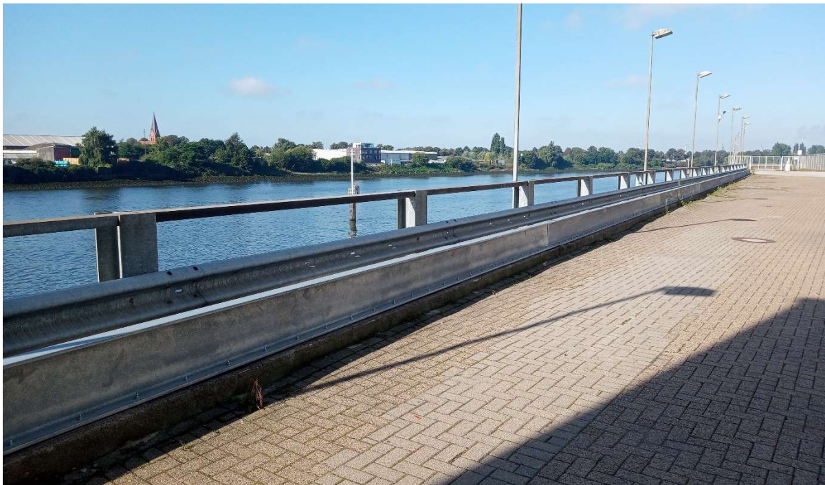
Abbildung 9: Hochwasserschutzanlage als UPE 400-Profile, Foto IL vom 28.09.21
