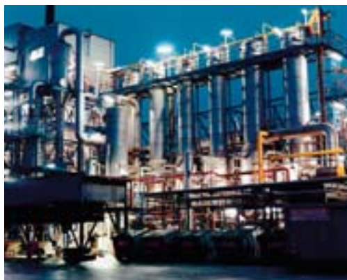
Erst Eindampfen, dann verbrennen: Dies ist Aufgabe der Eindampf- und Feuerungsanlage für flüssige Abfälle der Firma BREWA-Umwelt-Service
