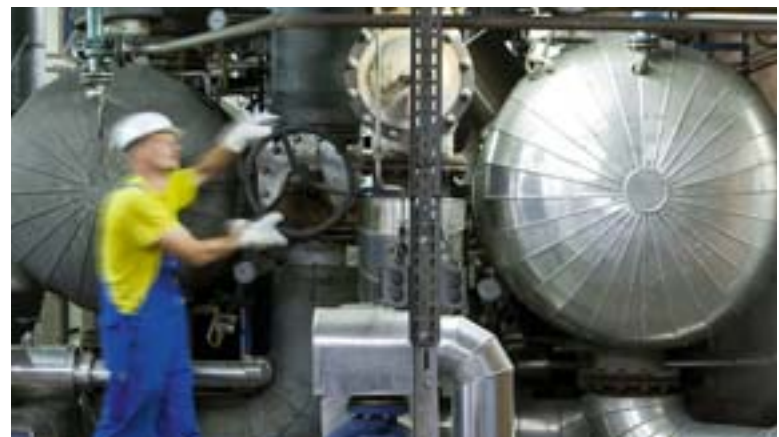
... Steuerung von Ventilen: Verantwortungsvolle Tätigkeiten im MHW Bremen
