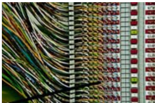
Wehe wenn ein Kabel falsch verbunden ist: Steuertechnik im MHW Bremen
