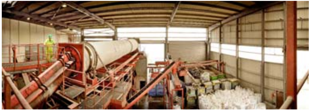
Hier werden Abfälle tiefgekühlt: Die Cryogenanlage der Firma Nehlsen-Plump trennt so Verpackungen und andere Materialien von schadstoffhaltigen Anhaftungen
