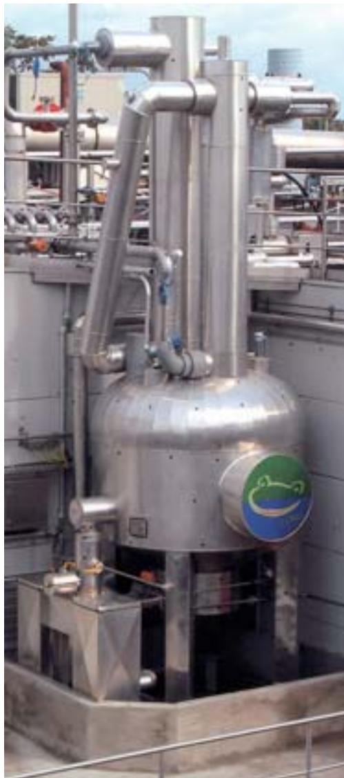
Vermeidung durch neue Technologien: Lösemittelrückgewinnungsanlage LÖRG
