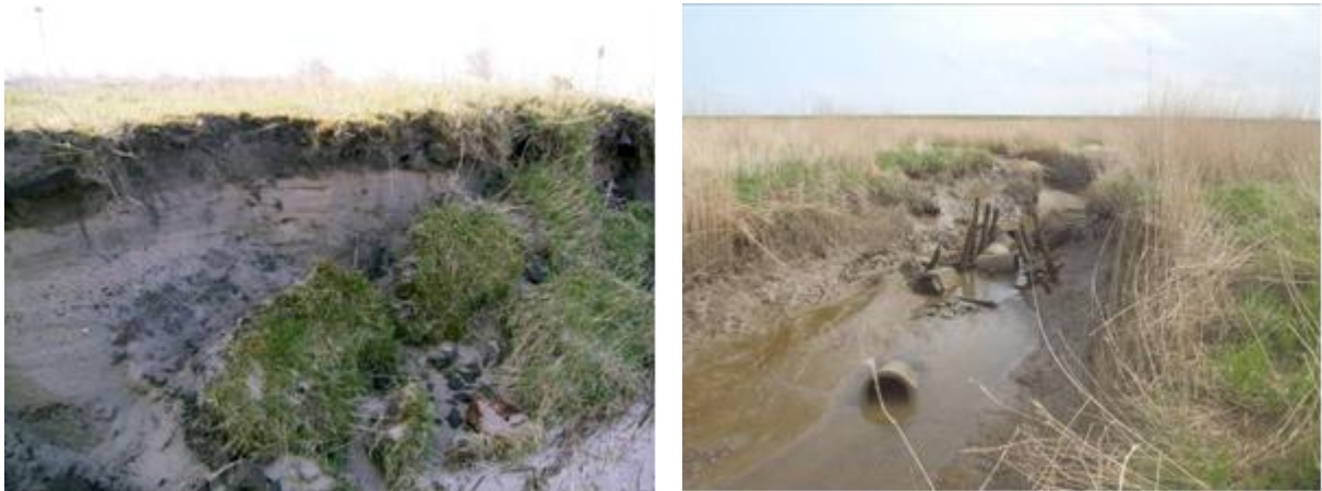
Abb. 14: Erosionsbereiche: 08.04.2008: Nordprielmündung (links); 15.03.2012:Hauptgraben in östliche Richtung (rechts).
