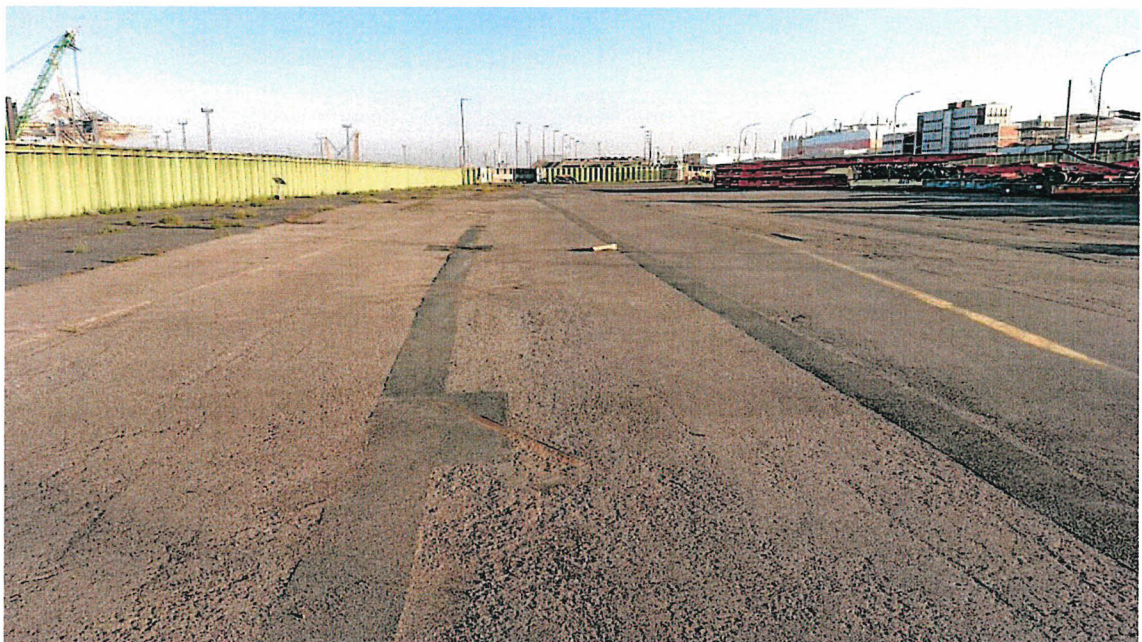
Foto 2: Überblick über die Fläche innerhalb der Bestandsspundwände mit Blick in Richtung Norden.
