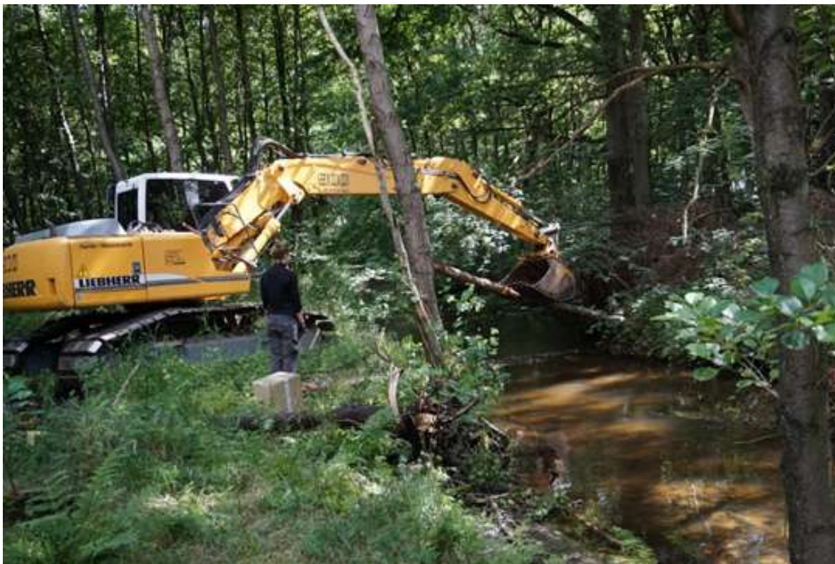
Naturnahe Gewässerentwicklung: Verbesserung der Abflussverhältnisse an einem norddeutschen Tieflandbach durch Einbringen von Gewässerstrukturelementen. Das Foto zeigt die Umsetzung und fachliche Begleitung der Maßnahme (Quelle: SUKW)
