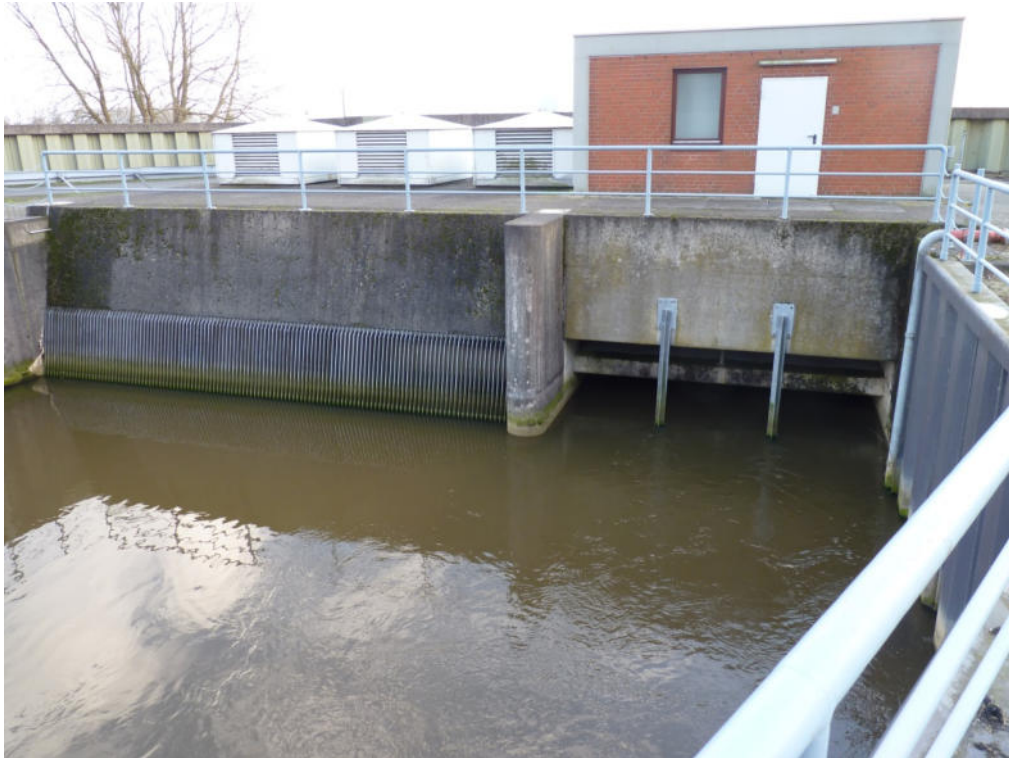
Abb. 9: Sielbauwerk im Mündungsbereich der Blumenthaler Aue (Blickrichtung von der Blumenthaler Aue aus).
