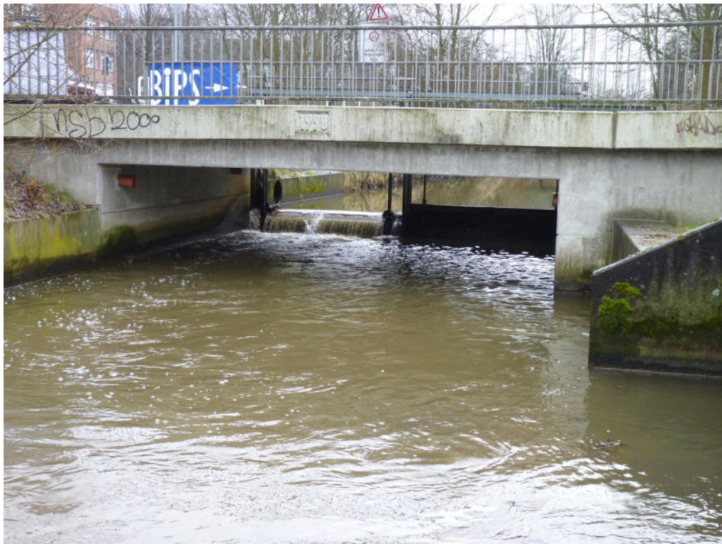
Abb. 13: Horner Stau (unterhalb des Bauwerks).
