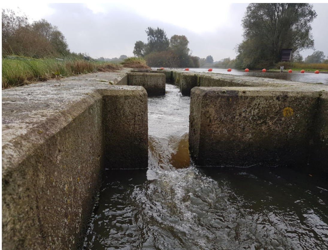
Abb. 6: 4-Kammer Fischpass an der Stauanlage Warfelde.
