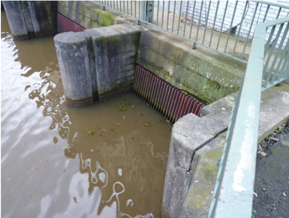
Abb. 18: Siel und Schöpfwerk Huchting, Detailaufnahme eines Auslaufsegmentes mit Rechen.
