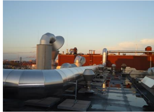
Abb. 27: Drei-Kammer-Wärmetauscher mit Abluftführung über Dach
