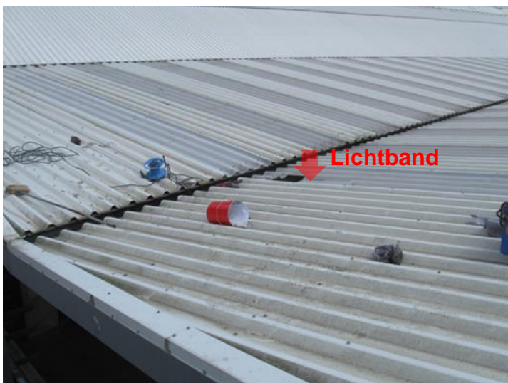
Abb. 4: Darstellung des Daches von oben mit Absturzstelle und Lichtband
