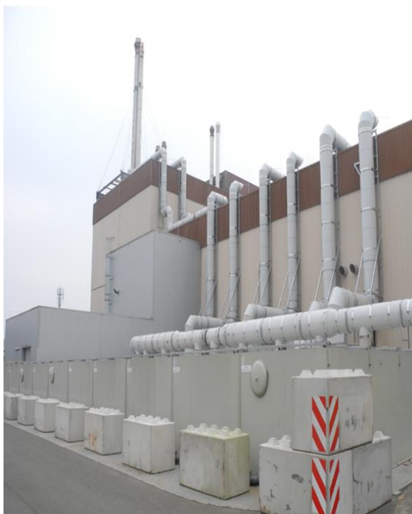
Abb. 24: Container als Biofilter
