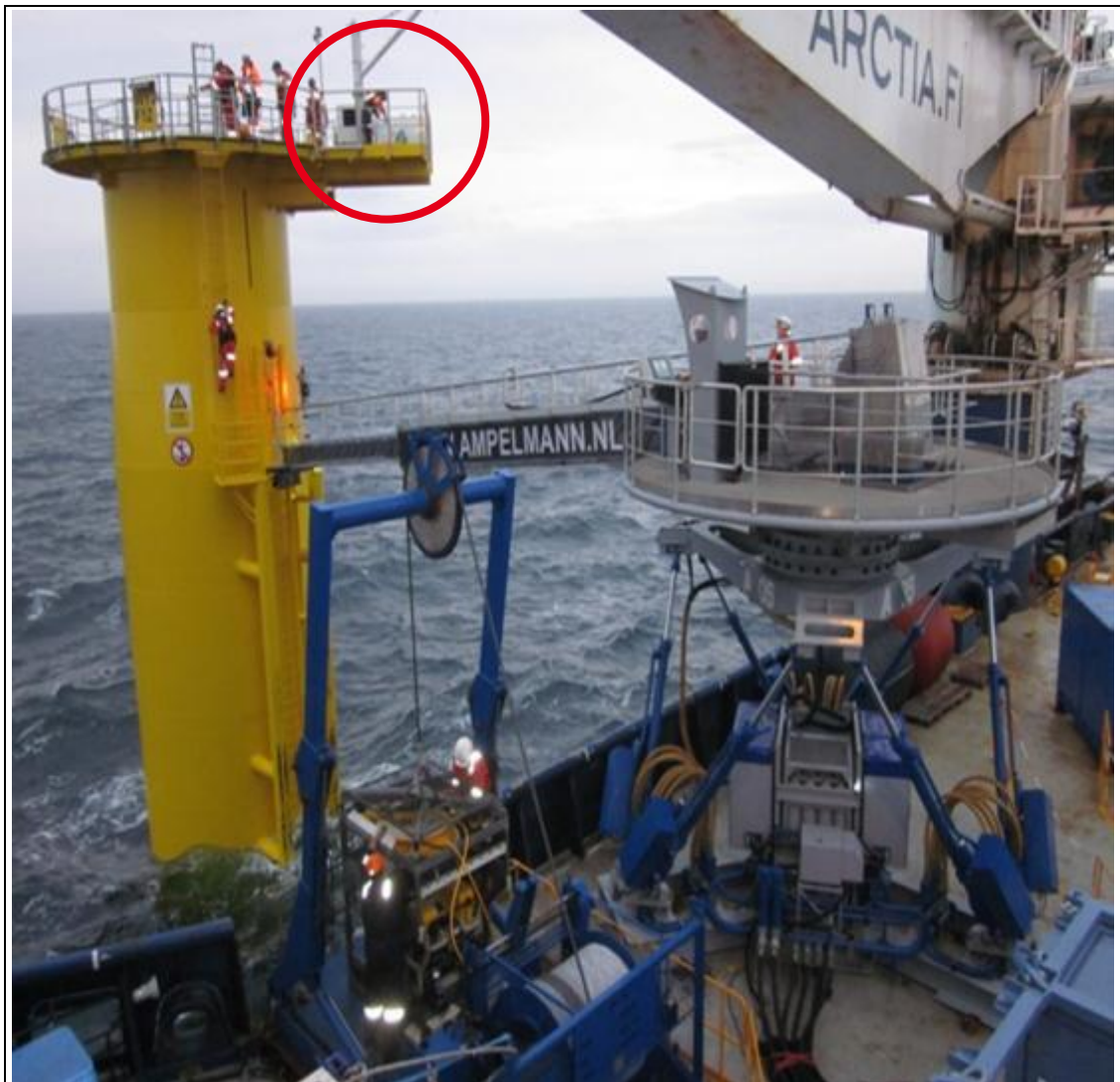
Abbildung 13: Installation Offshore Baustelle – Irische See, sog. secondary steel mit roter Umrandung markiert
