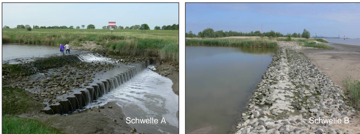
Abb. 4 Schwelle A am Treuenfelder Arm (Höhe NN 1,80 m NN; langer Wasserabfluss über die Niedrigwasserphase) und Schwelle B an der Weser (Höhe 2,0 m NN) bei Niedrigwasser
